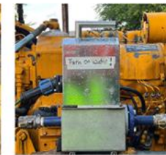
h. Flow Meter
