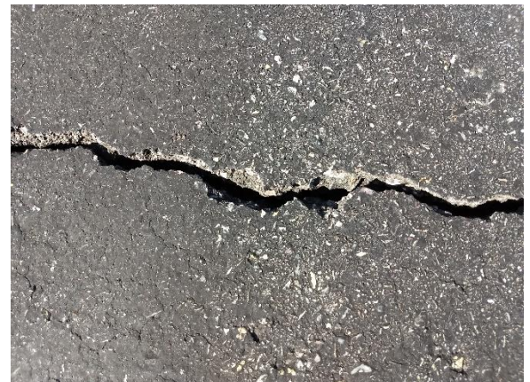
T-2, Transverse Crack
