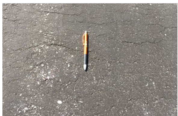
T-5, Slip Crack
