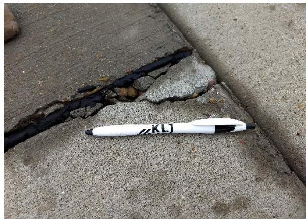
A-3, Corner Spall
